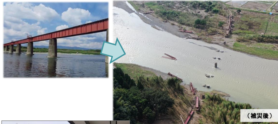
くま川鉄道 球磨川第4橋りょうの被災状況
