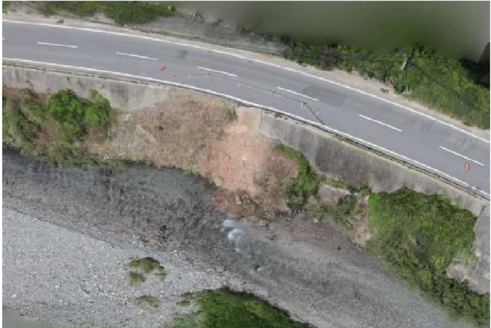
ドローン写真とレーザー測量を組み合わせる3D化した例(H26. 岩手県 豪雨)
