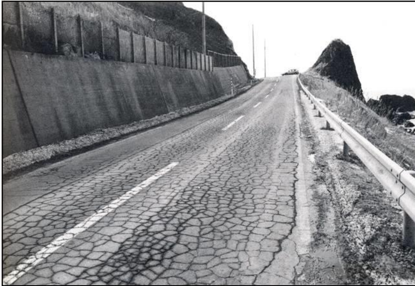
舗装面の亀甲状クラック
