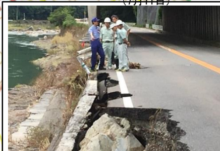
⑦国道212号の被災状況調査（中津市） ※ 査定前着工（路面、路肩の仮復旧等の現地指導（7月10日）
