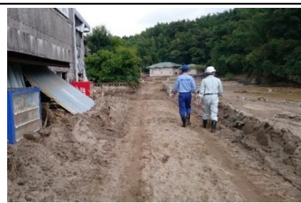
②赤谷川の被災状況調査（朝倉市） ※ 査定前着工（護岸の仮復旧及び復旧工法）を現地指導（7月12日）
