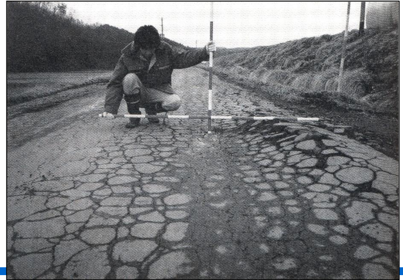
舗装面の盛り上がり、沈下
