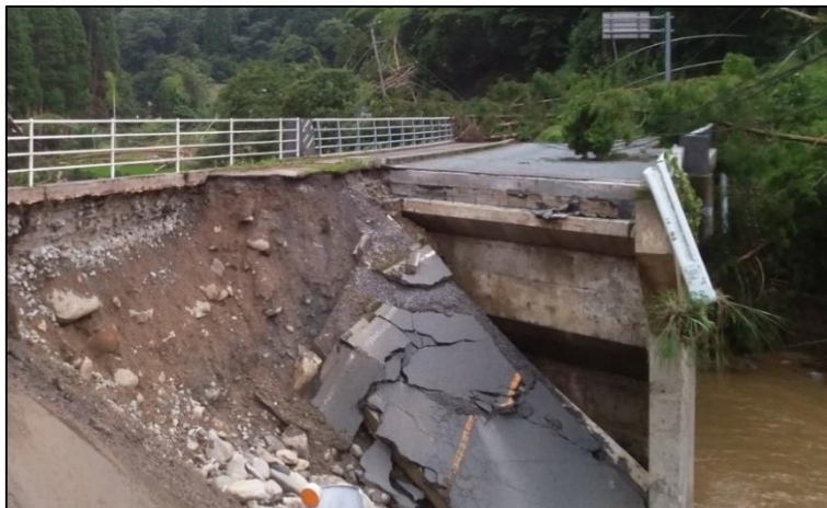
【国道211号(東峰村福井地区)の被災状況】
