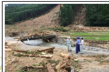
④鶴河内川の被災状況調査（日田市） ※ 査定前着工（流木撤去と復旧工法について現地指導（7月11日）
