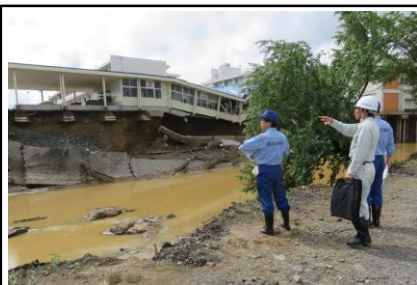
①桂川の被災状況調査（朝倉市） ※ 査定前着工（中学校基礎への影響と復旧工法）を現地指導（7月9日）
