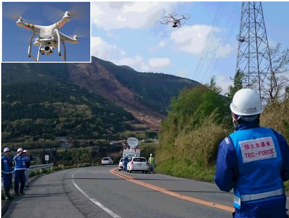
ドローンによる土砂崩壊箇所の被災状況調査 (南阿蘇村)
