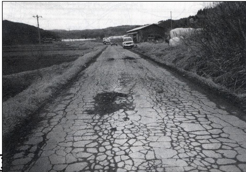
舗装剥離による穴
