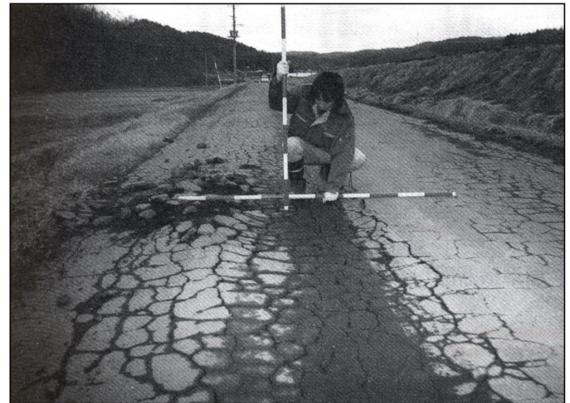
舗装面からの土の噴出
