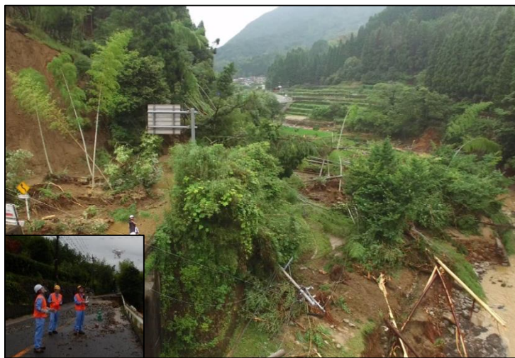
【大肥川(国道211号)法面崩落(7/8): 国土地理院】
