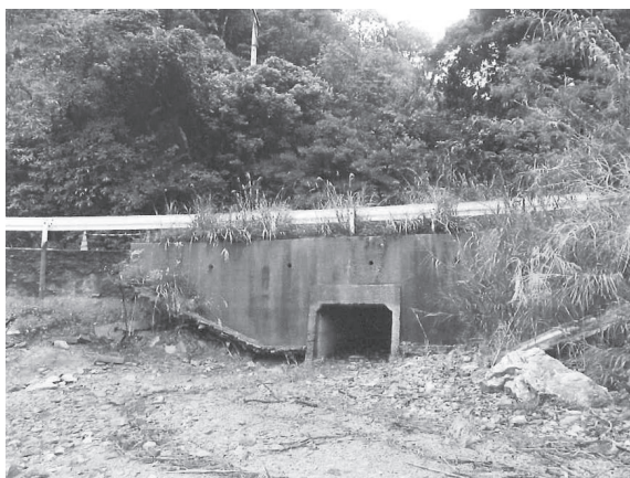
平成19年災被災状況
