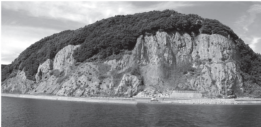
被災箇所海からの全景
