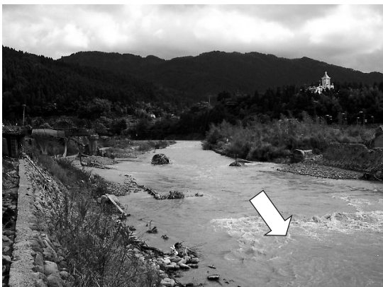
市波～福島 改良工区 JR 第5橋梁（流失）
