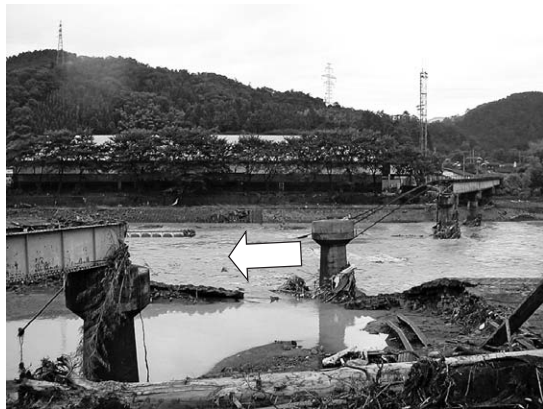
脇三ヶ町～宿布町改良工区 JR 第1橋梁（流失）
