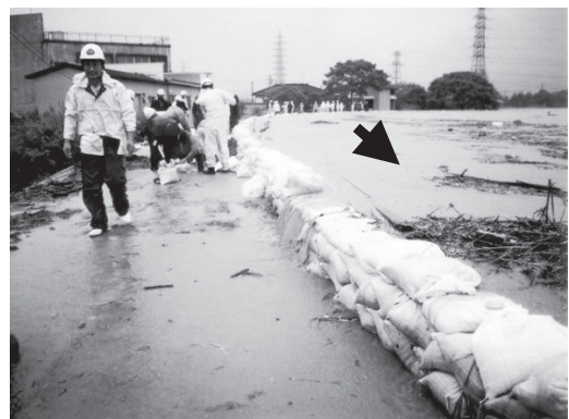
三竹地区(右岸) 越水状況 (H16.7.13)
