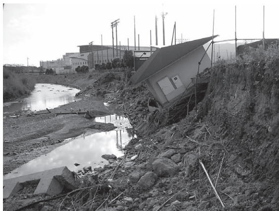
写真-4 護岸が破壊され、破堤した加茂地区
