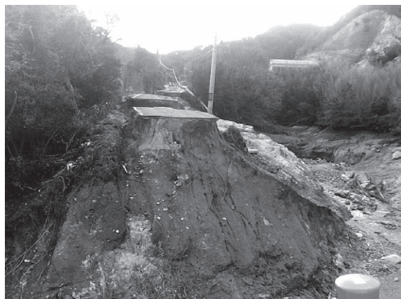
写真-1 崩落し原形をとどめない県道鳥飼浦洲本線
