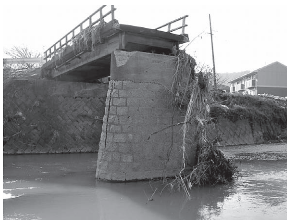
写真-5 辛うじて残った大森谷橋上・下部工
