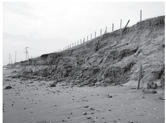
被災状況写真
