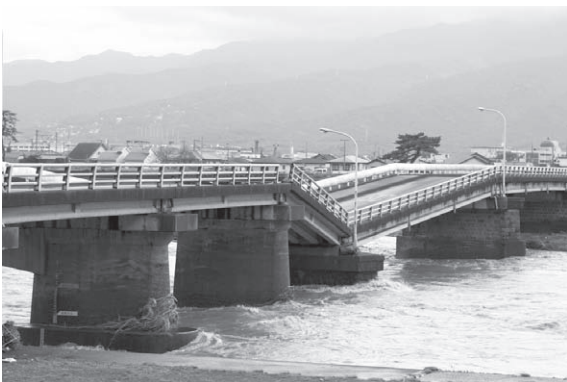
写真-5 被災状況
