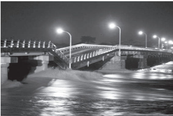
写真-4 被災状況
