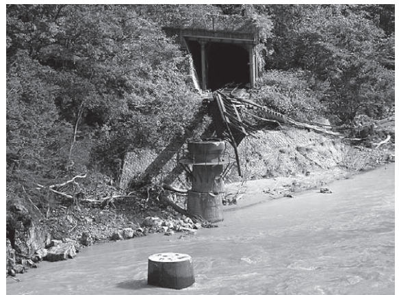
写真-2 JR 鉄道橋の流失（宮川町地内）
