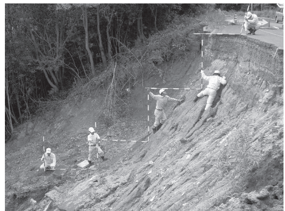
写真-4 被災箇所を測量している様子
