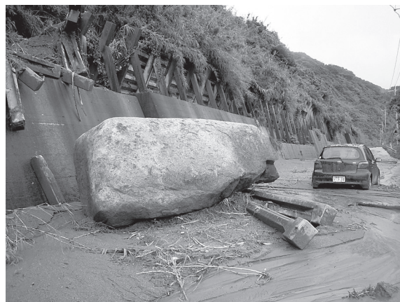
写真-1 平成19年災被災状況 (国道269号佐多浮津での落石・崩土状況)
