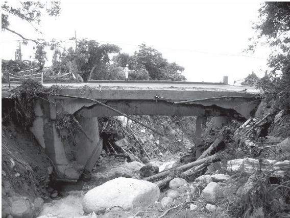
写真-2 平成19年災被災状況 (土石流により被災した国道269号炭屋橋)
