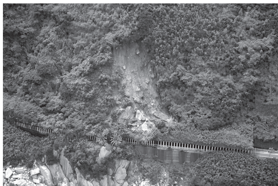
写真-7 ロックシェッド上に堆積した土砂・落石
