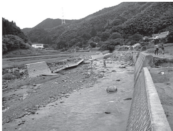
八木山川（宮若市）の災害状況
