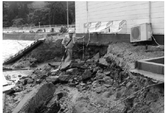
写真-7 被災状況
