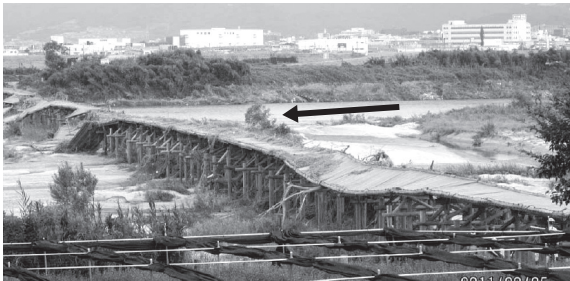
18回目の被災(左岸側から)
