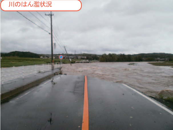
道路の崩壊状況
