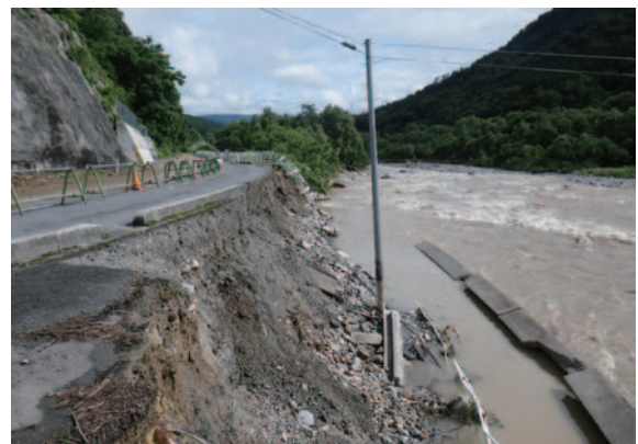
写真－10 河川の増水による道路欠壊（西川町）
