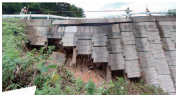
写真-13 補強土壁工の被災（白鷹町）
