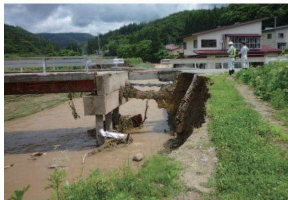
写真-16 河川増水による護岸の欠壊（南陽市）
