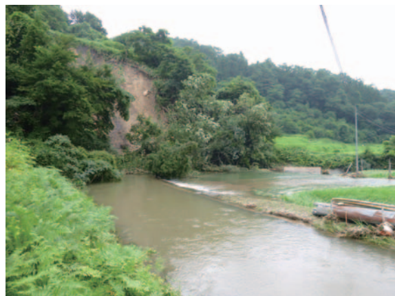
写真-15 土砂崩落による河道閉塞（朝日町）
