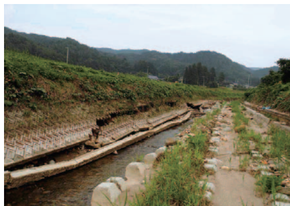
写真-17 護岸の洗掘崩壊（白鷹町）
