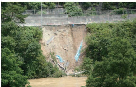
写真-11 道路欠壊により全面通行止（白鷹町）
