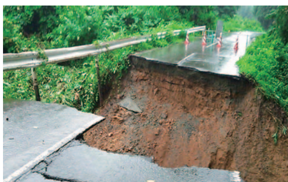
写真-12 道路の流出（山辺町）
