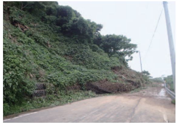
H25.9 (主)輪島浦上線法面崩壊（輪島市）
