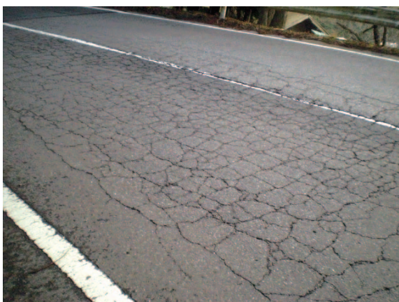
写真-2 凍上災の被災状況
