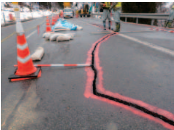
写真-1 地震により発生した路面のクラック
