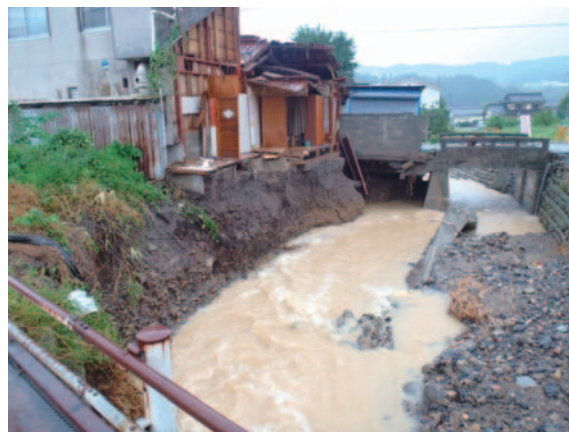
写真-3 関連事業を申請した一級河川唐沢川の被災状況
