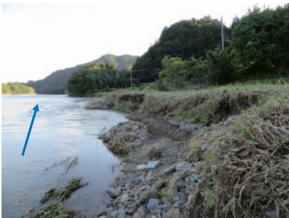
平成25年発生災害 堤防浸食箇所（久慈川）
