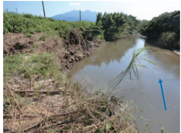
平成25年発生災害 堤防浸食箇所（桜川）
