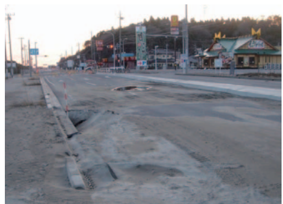
東日本大震災 液状化による被災 （国道245号：日立市内）
