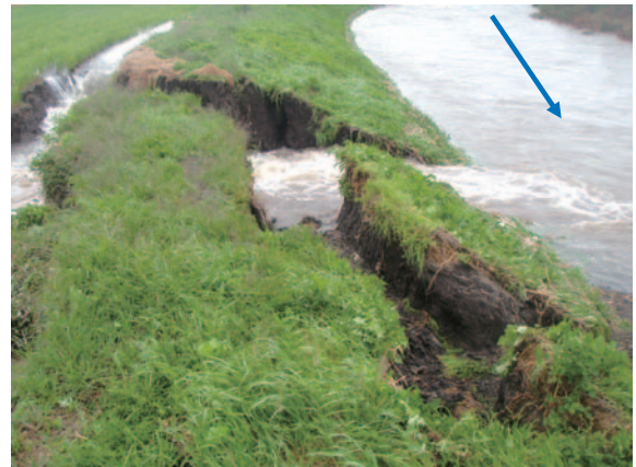
平成25年発生災害 堤防決壊箇所（清明川）
