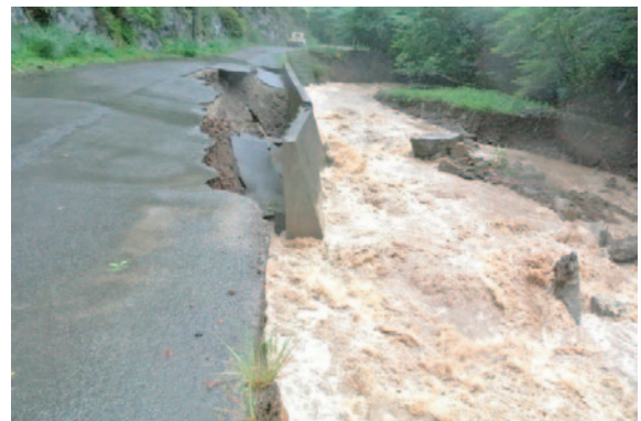
写真－4 25年災 市道広井原三又線の被災状況（護岸浸食により道路が崩壊した）
