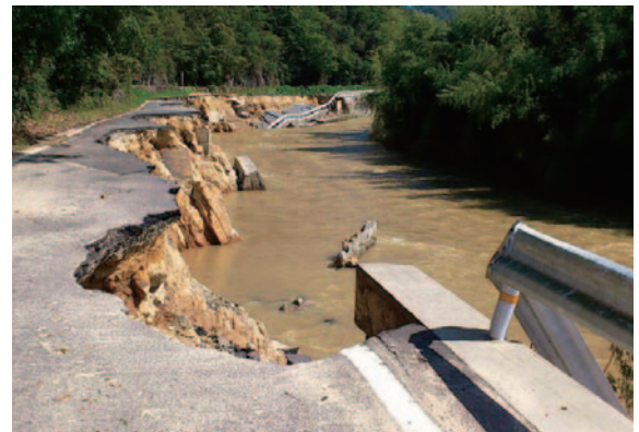
大戸川 被災状況
