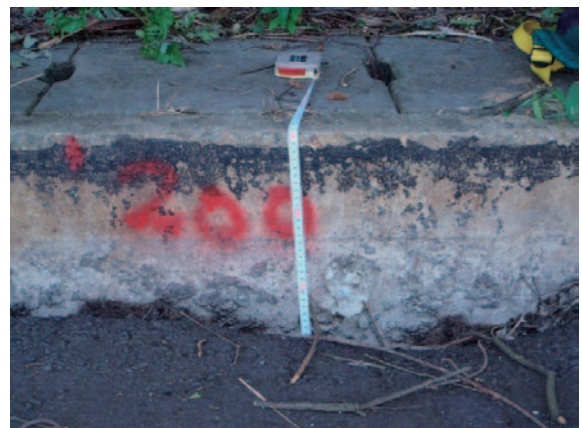
水路と舗装の段差
