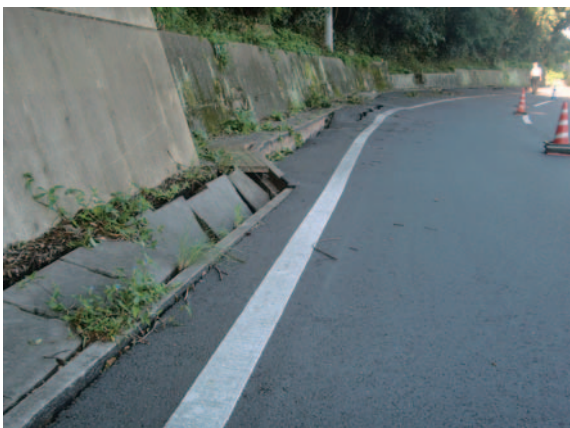
水路及び舗装の損傷
