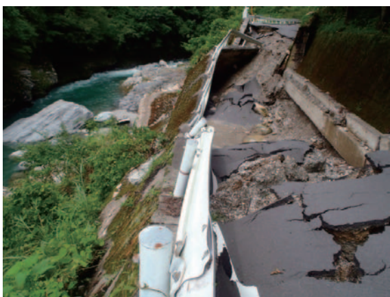
写真-4 道路災害 県道坂瀬瀬吉野線 (本山町坂本)
