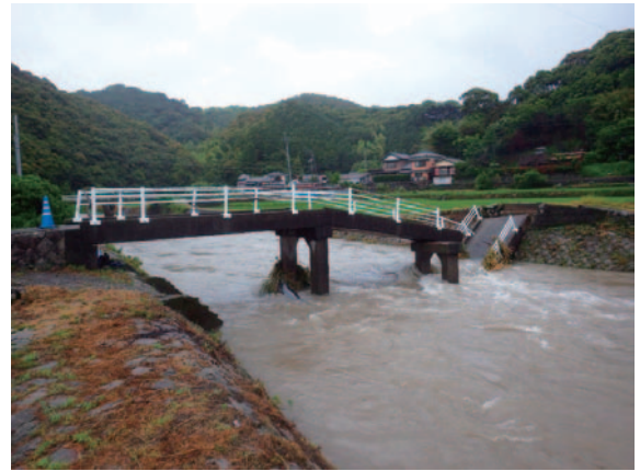
写真-1 橋梁災害 法寿院橋(黒潮町有井川)
