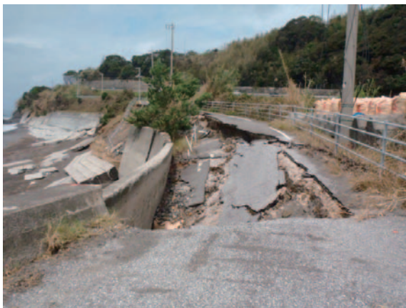
写真-3 道路災害 県道高知安芸自転車道線 (安芸市穴内)
