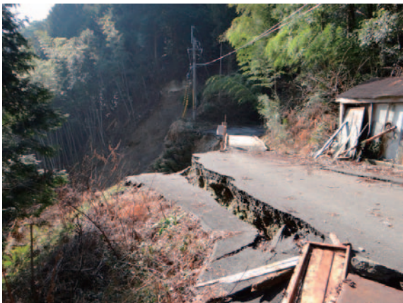
写真-7 道路災害 町道浦ノ谷線(大豊町立川下名)
