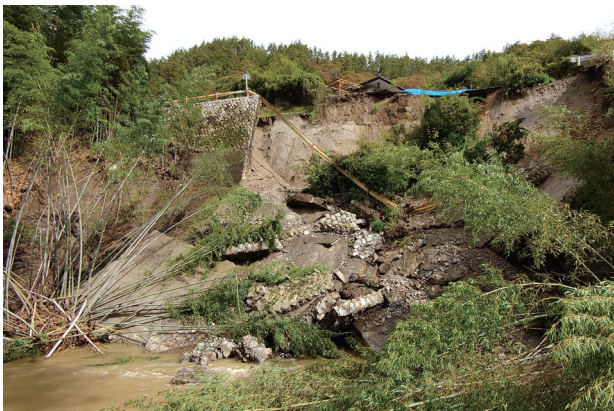
写真-18 込地集落の村道崩落の様相
