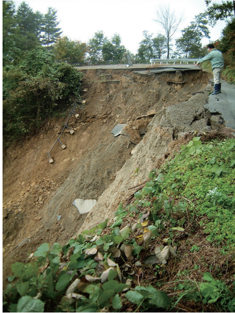
写真－6 高津屋地籍の大崩落状況
