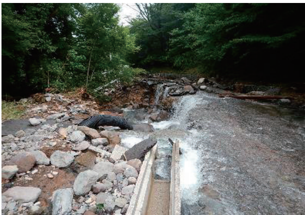
写真-4 令和2年災害 道路路肩崩壊状況
