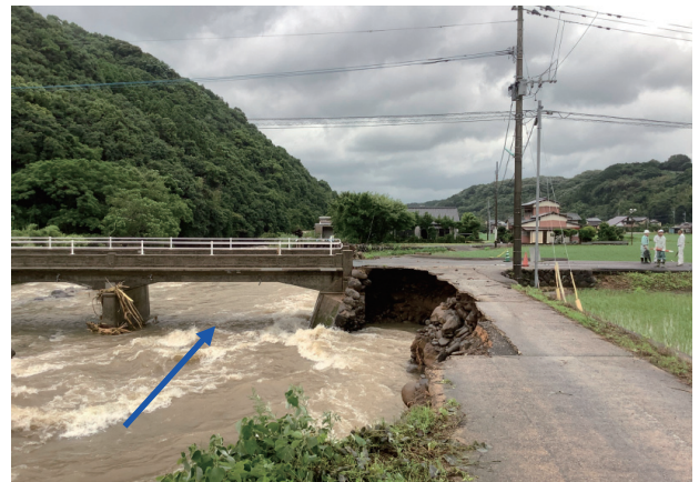
写真-5 令和2年災害 河川護岸流出状況
