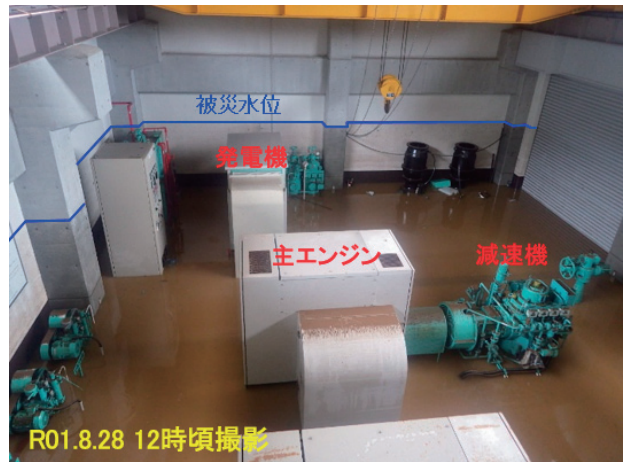
写真－6 排水機場建屋内浸水状況
