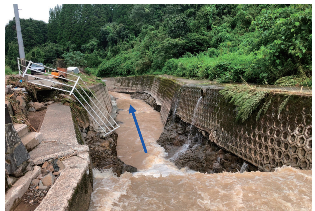
写真－2 令和元年災害 河床洗掘状況
