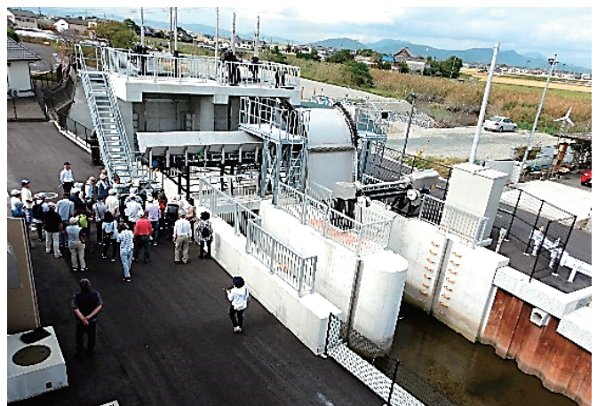
写真-4 厘外雨水ポンプ場
