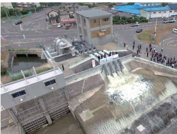
写真-3 石塚雨水ポンプ場
