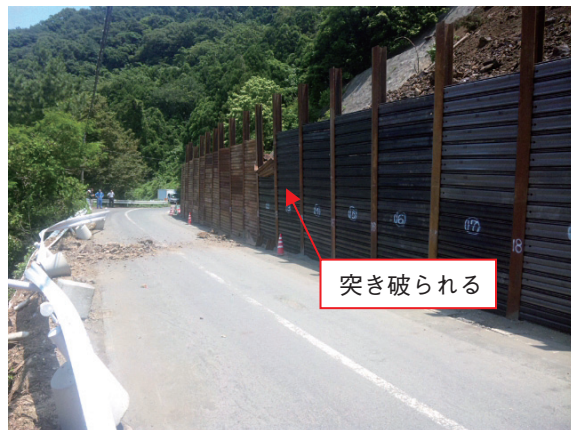
写真-5 6月21日再崩壊の状況
