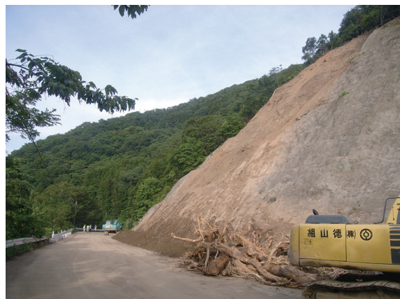
写真-4 6月6日崩土撤去後の状況
