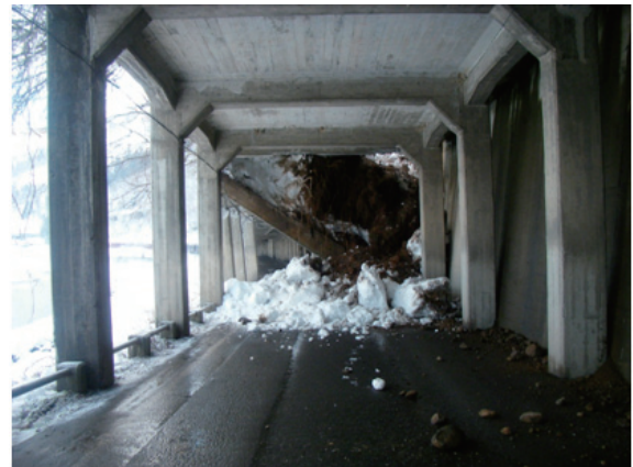
(一)箕作飯山線 栄村 清水河原スノーシェットの被災状況
