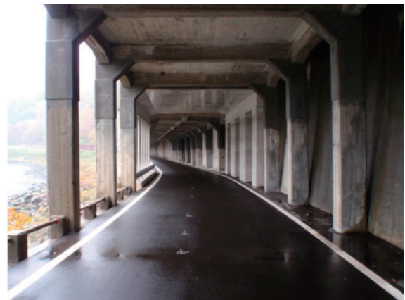
(一)箕作飯山線 栄村 清水河原スノーシェットの復旧状況
