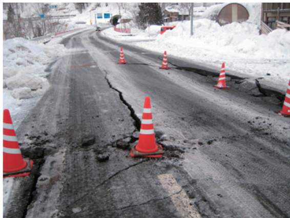
(国)117号 栄村の道路面の被災状況
