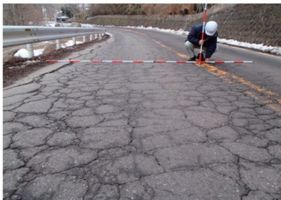
凍上災による被災状況
