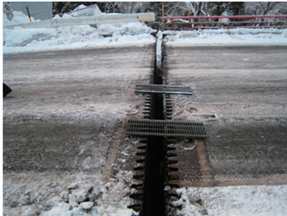
(国)117号 栄村 栄大橋の被災状況 橋桁が移動し遊間が広がっている
