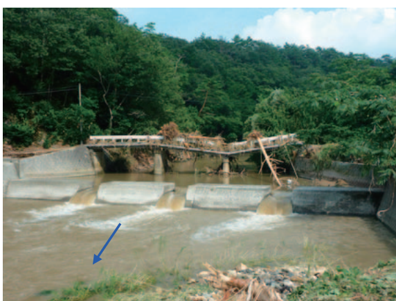
写真一12 市道小原線（上小原橋 橋脚沈下）
