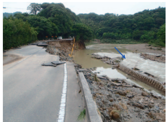
写真一 3 主要県道津和野田万川線 (道台兼用護岸崩壊)
