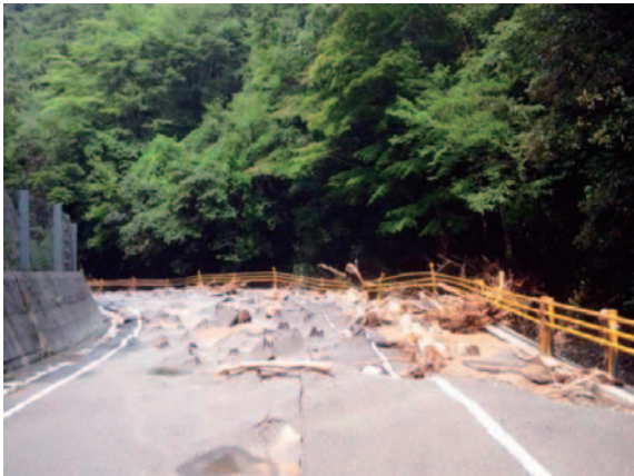
写真一4 一般県道津和野須佐線（舗装版陥没）
