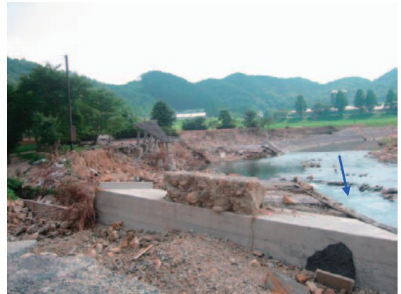
写真一7 二級河川阿武川（護岸崩壊）
