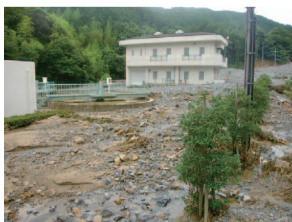
写真一15 須佐浄化センター（下水道 土砂埋塞）
