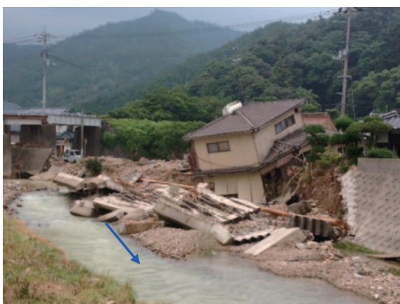
写真一11 二級河川須佐川（護岸崩壊）
