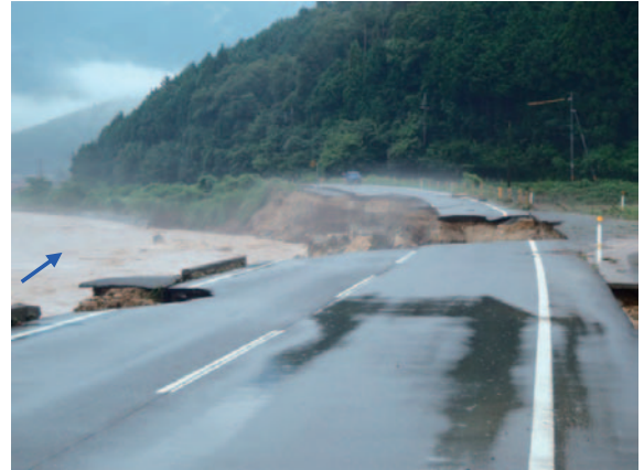
写真一 1 国道315号 (道台兼用護岸崩壊)
