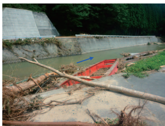
写真一14 市道吉部野山田線（山田橋 上部工流出）
