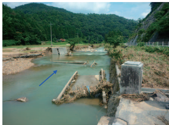
写真一13 市道山用線（山用橋 上部工流出）
