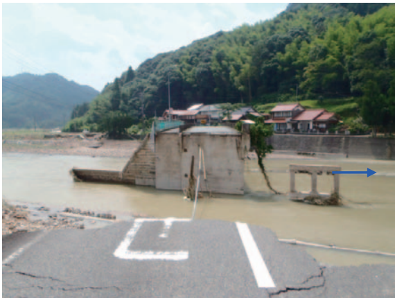
写真一5 主要県道益田阿武線（道台兼用護岸崩壊）
