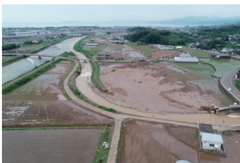
写真-1 河川護岸決壊状況
