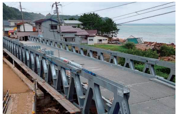
写真-12 国土交通省による応急組立橋設置完了 (国道279号小赤川橋)
