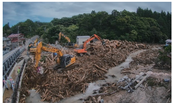
写真-13 小赤川流木撤去状況 (むつ市大畑町) ライブカメラ画像
