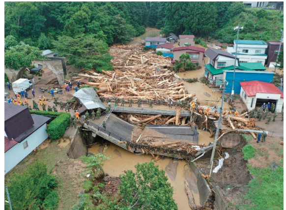
写真-1 落橋した国道279号小赤川橋 (むつ市大畑町)
