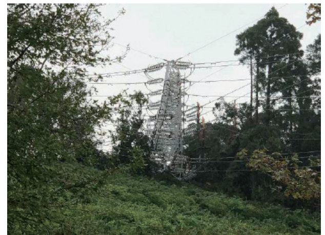
強風による鉄塔倒壊状況
