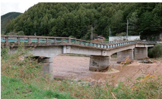
写真-2 橋脚の沈下により橋桁が損傷（川上村）
