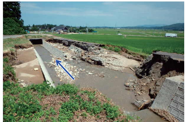
写真－4 護岸被災状況（山間部）
