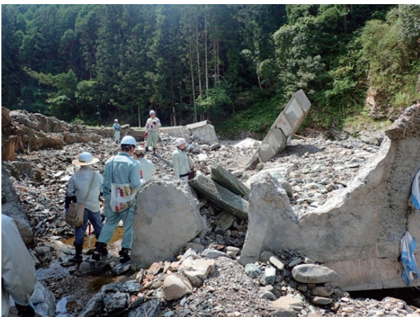
写真-4 黒川護岸被災状況（朝倉市）
