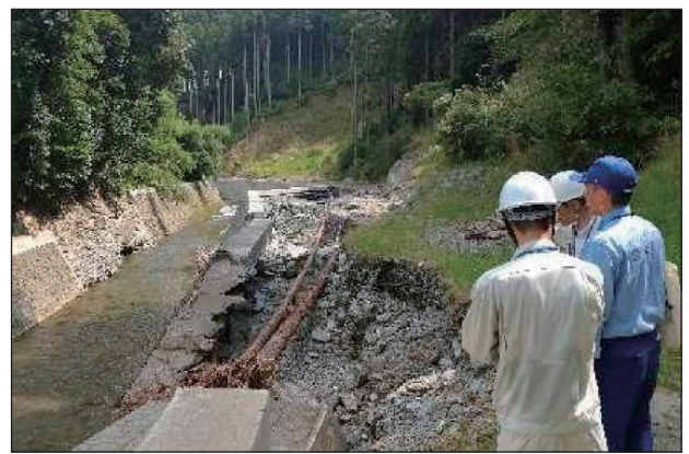
写真-2 災害緊急調査（黒川：朝倉市）
