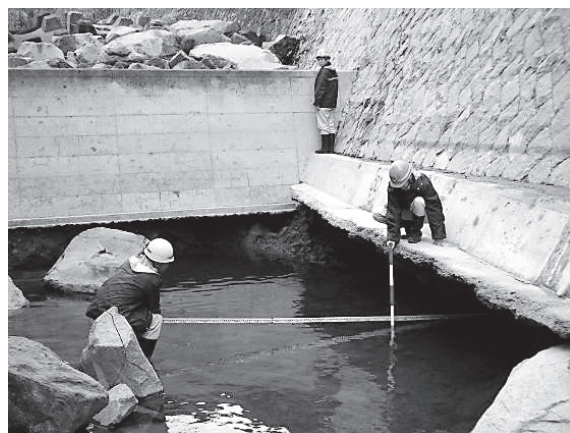
写真－1 既設護岸基礎部の露出状況
