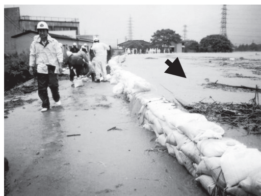
三竹地区 (右岸) 越水状況 (H16.7.13)
