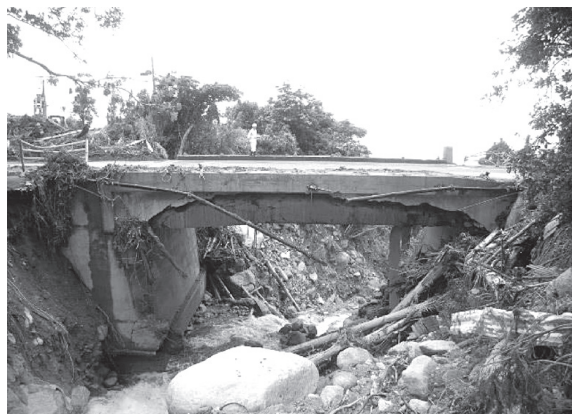
写真-3 土石流で被災した国道269号炭屋橋
