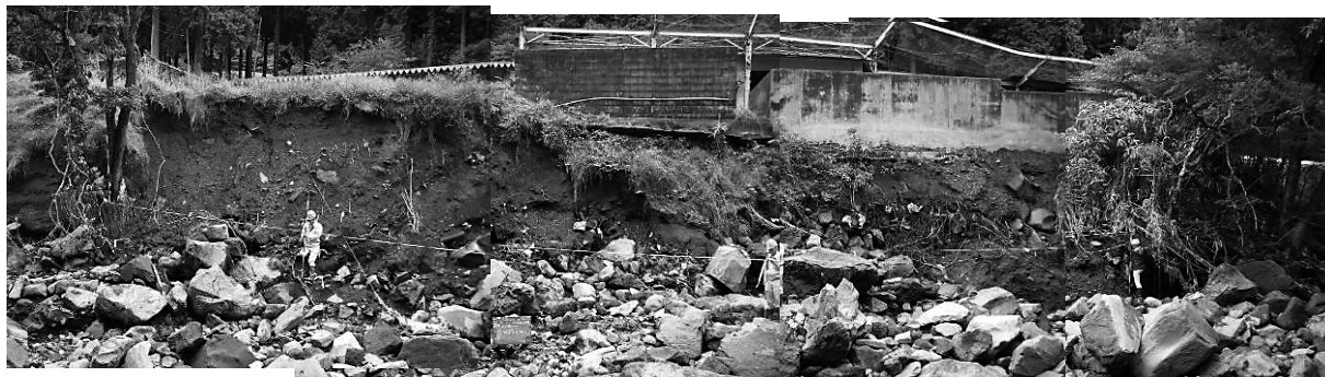
写真-3 土羽護岸の被災状況
