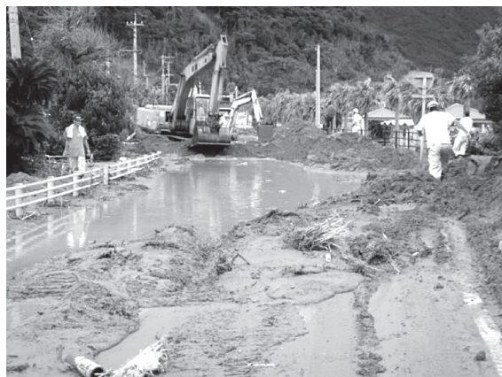
写真-5 土石流で埋まった国道269号
