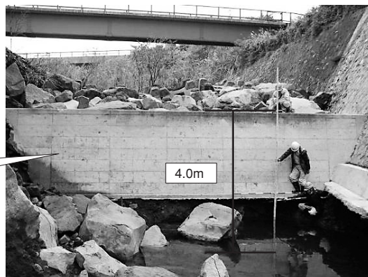
写真－2' 被災後の状況（4.0mの河床低下）
