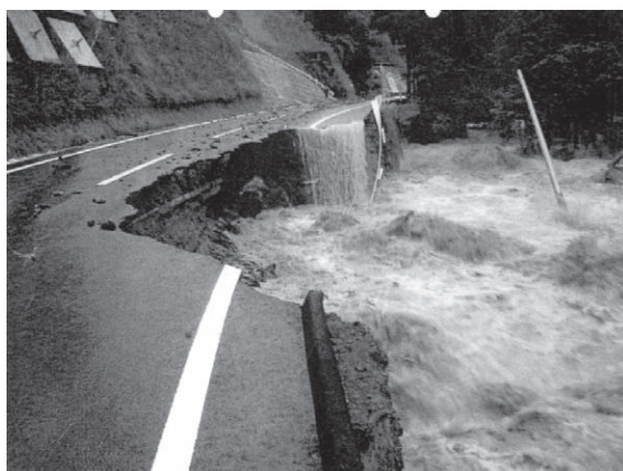
国道445号被災状況
