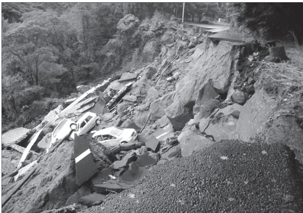
主要地方道 都城隼人線の被災状況（鹿児島県霧島市）
