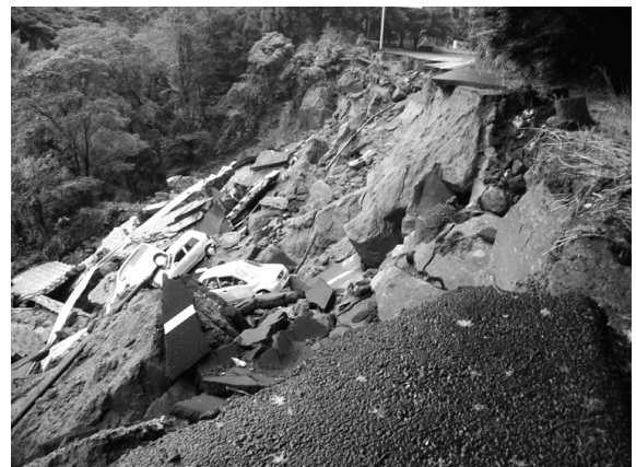
写真－4 鹿児島県霧島市主要地方道都城隼人線の被災状況
