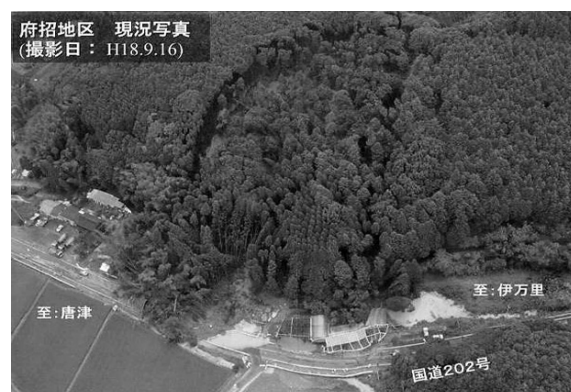
写真-5 一般国道202号地すべり状況
