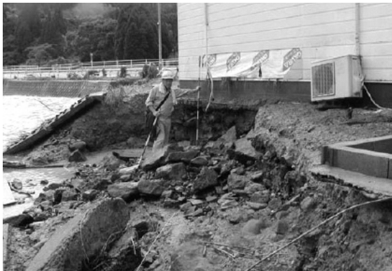
写真－7 被災状況
