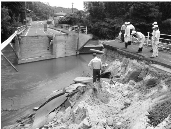
写真－1 宮崎県都城市1級河川丸谷川の被災状況
