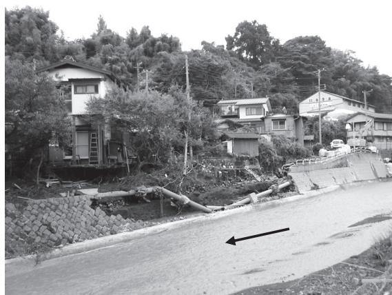
写真－4 野沢川 護岸倒壊と人家への被害
