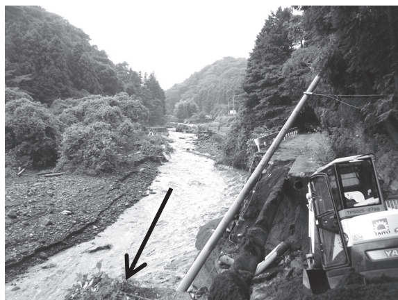
写真③ (二)須川 護岸崩壊と水道本管露出
