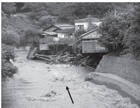
写真－2 須川 護岸倒壊と人家への被害
