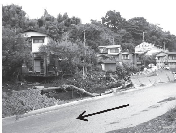
写真② (二)野沢川 護岸崩壊と家屋被害 (洪水により家屋の基礎が流出)
