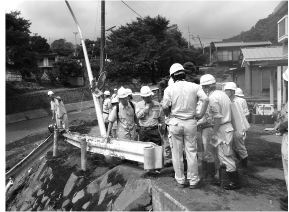
町道橋梁流失箇所の調査
