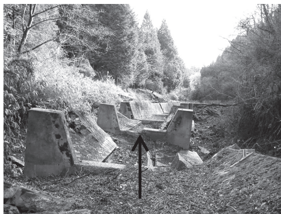
(普)須走排水路 被害状況
