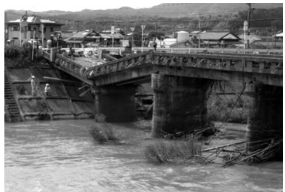
山口県山陽小野田市 厚狭川の氾濫による被災状況
