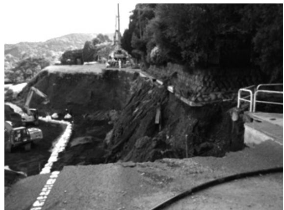
静岡県小山町 町道足柄三保線の被災状況
