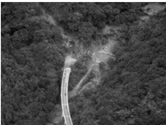
静岡県小山町 国道 246 号の被災状況
