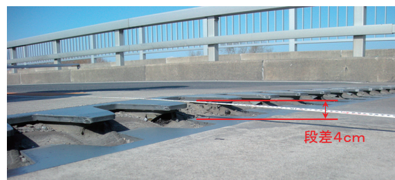
路面(伸縮装置)の被災状況(段差4cm)
