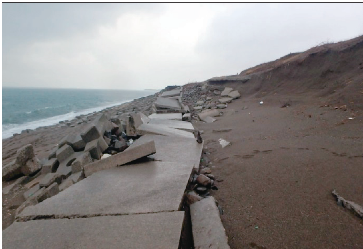
平成26年12月 風浪による被災状況 (上越市)
