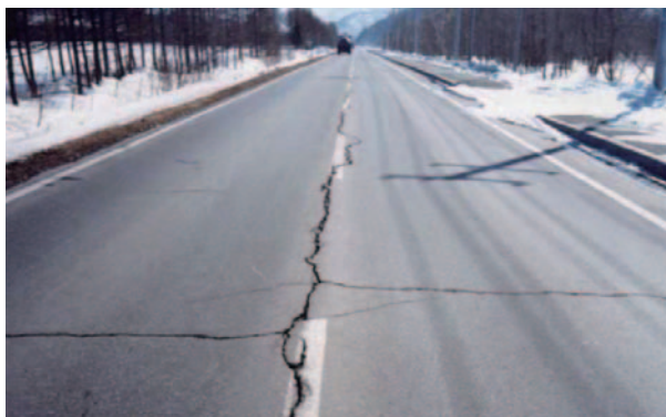
凍上によるひび割れ
