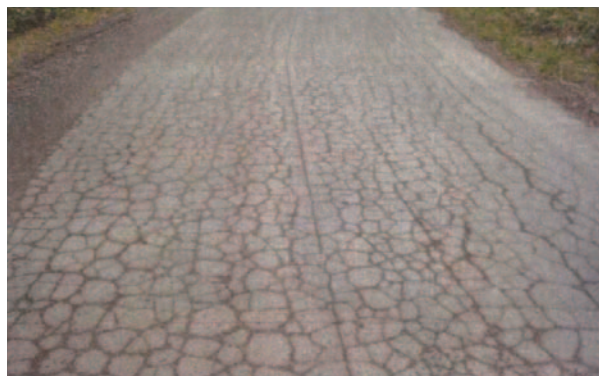
路面の亀甲状クラック
