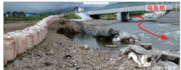
写真-2 福島橋下流 護岸の被災状況
