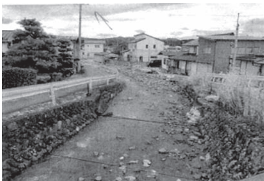
写真-2 終点側の埋塞土除去前の事例（台風19号）
