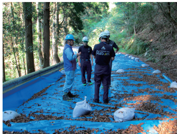
町道猪鹿倉横谷線地すべり箇所
