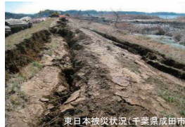
東日本被災状況(千葉県成田市)
