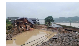
球磨川堤防の破損状況(熊本県人吉市)
