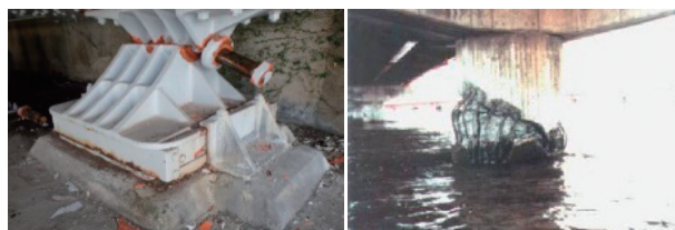
写真－4 支承の破損 写真－5 橋脚のせん断破壊
