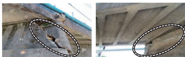
写真－2 洪水による被災 (橋脚のせん断破壊及び上部工床版下面のひび割れ)
