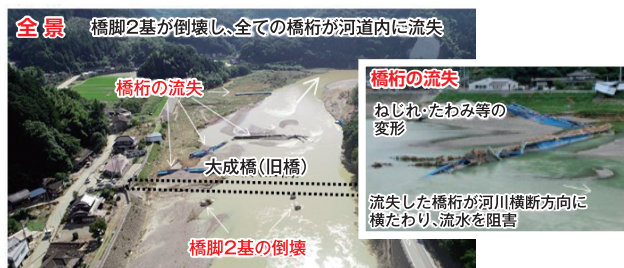
写真－1 洪水による被災 愛媛県大洲市 市道大成橋線(大成橋)
