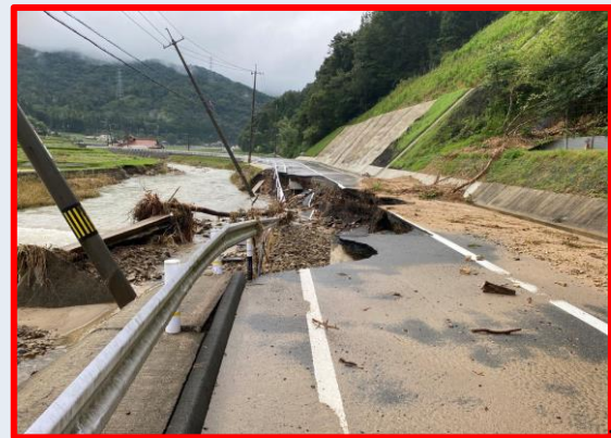
護岸崩壊・町道流出箇所
