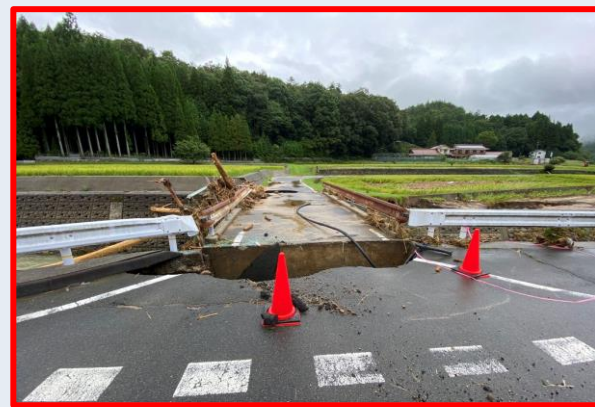
橋台裏の浸食箇所
