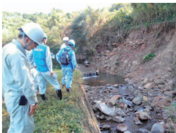
岩屋川内川護岸被災状況
