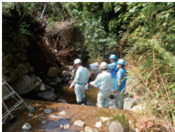
申川内川護岸被災状況
