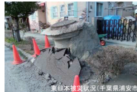
東日本被災状況(千葉県浦安市)
