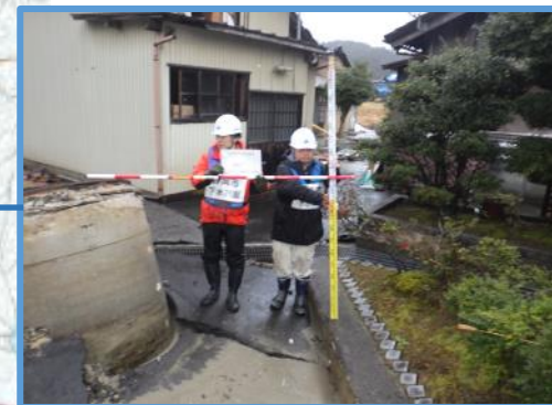
液状化・マンホール浮上
