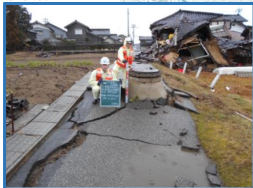
液状化・マンホール浮上
