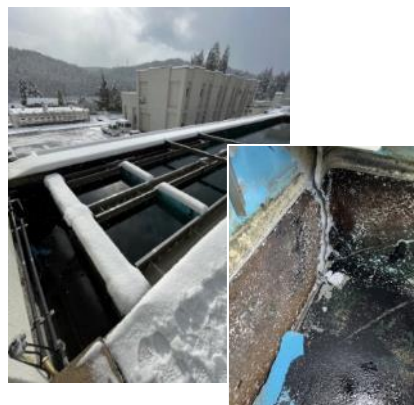
宝立浄水場浄水施設の損傷
