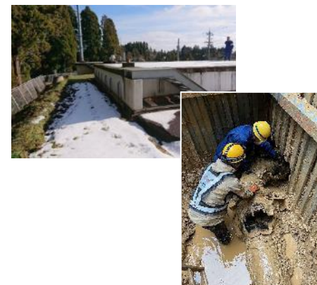
宝立配水池流入管の損傷
