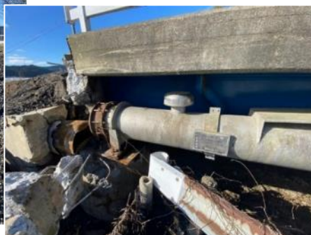
水管橋の損傷
